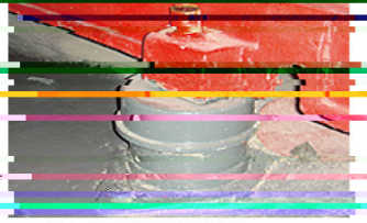
图8 使用弹簧隔震器安装 优质工程做法解析:设备安装牢固,运行稳定,运行效果良好。离心泵采用隔震器方式安装,位置合理,安装牢固,减震降噪效果良好。
